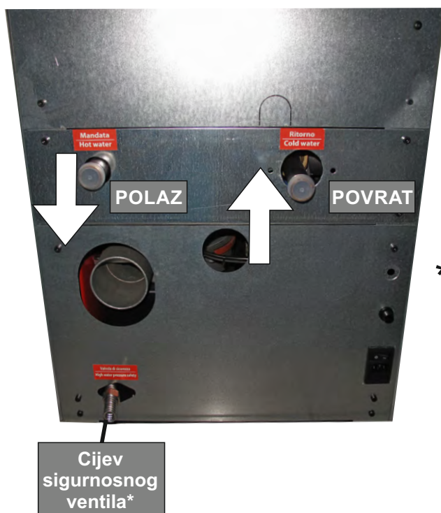
Slika 5. Polaz, povrat i cijev sigurnosnog ventila
